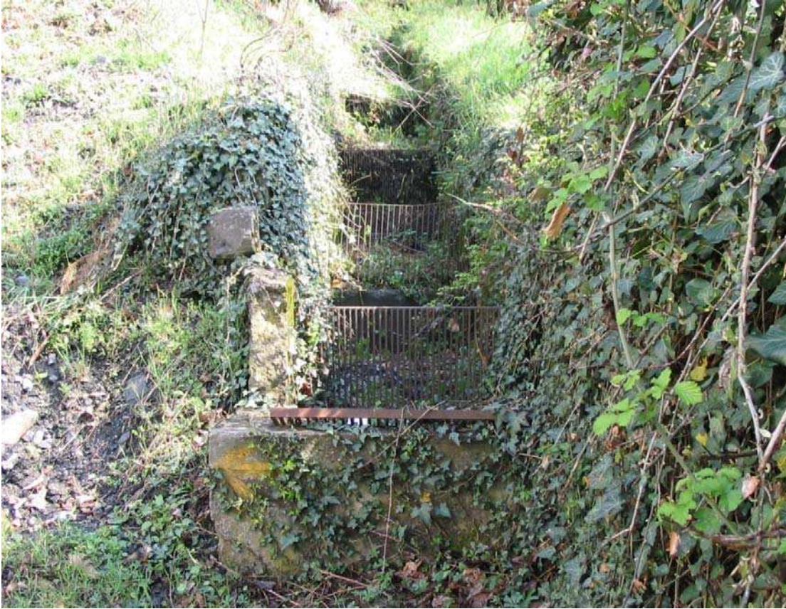
Foto 011 – Opera BATTCA011 . Ripresa da valle del settore di monte a sezione aperta.
