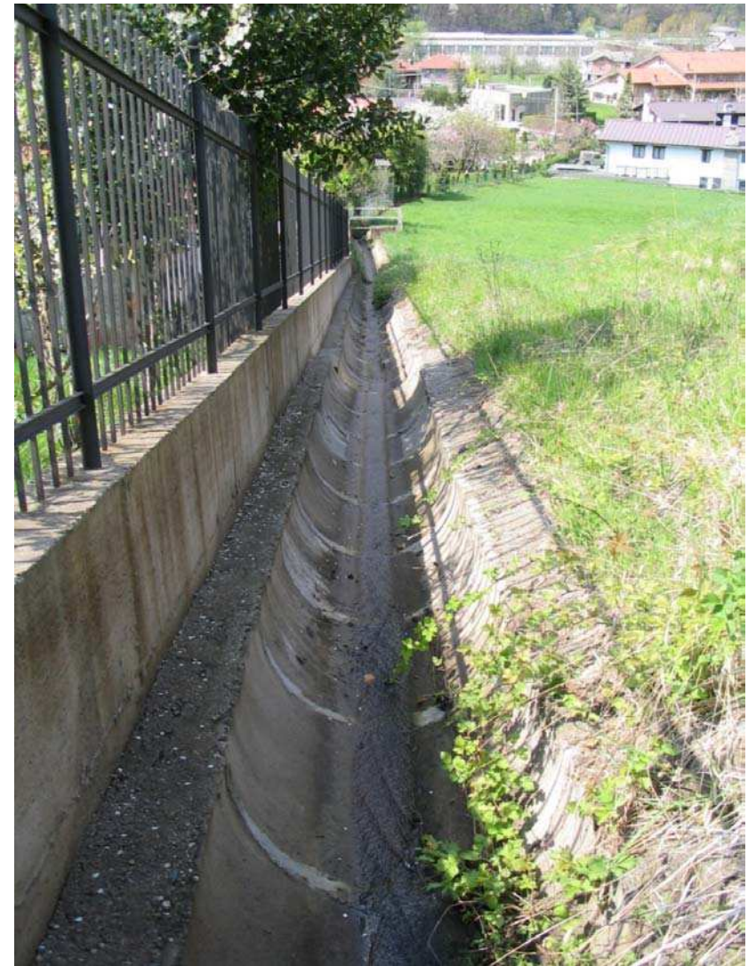
Foto 010 – Opera PENNCA010 . Ripresa da monte, sulla verticale della sezione aperta.
